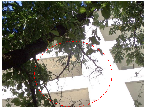
②枯枝（建物側）
